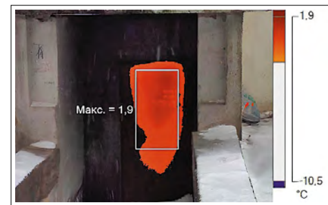
Неутепленная дверь в подвал
