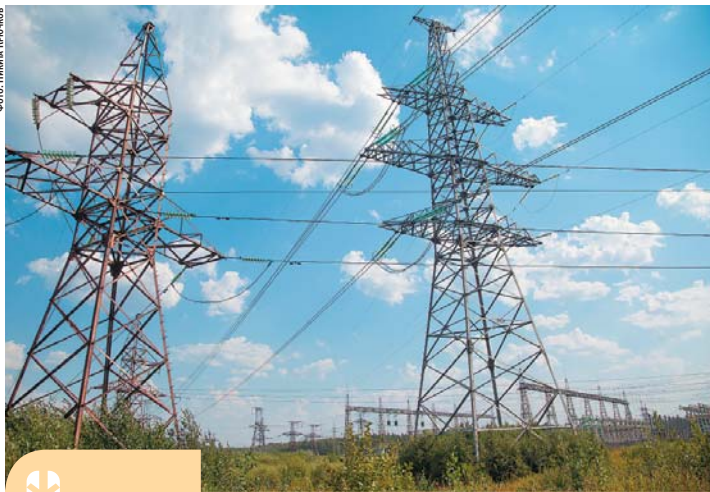
В развитие магистральных сетей Северо-Западного региона ФСК ЕЭС инвестирует почти 13 млрд рублей
