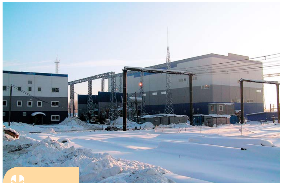
Подстанция Южная, г. Санкт-Петербург
