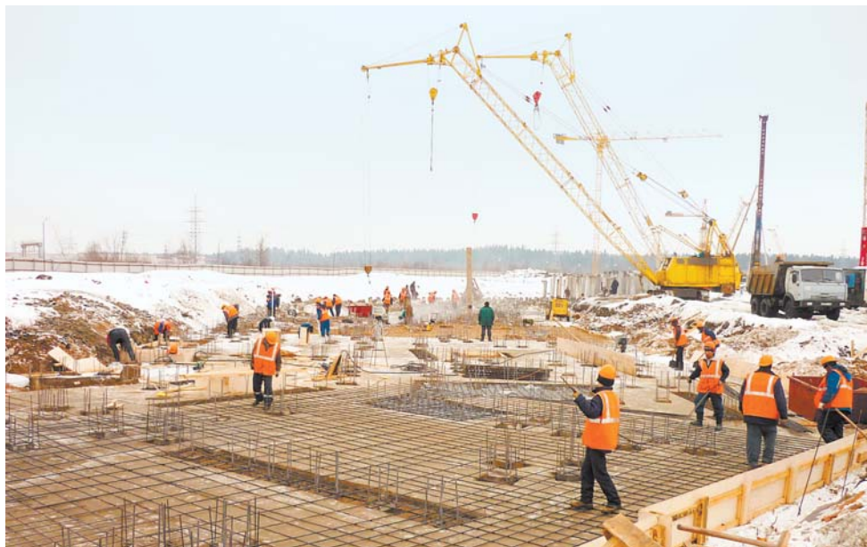
На площадке «Северной долины» завершено устройство фундаментов и цокольного этажа, началась отливка этажей
