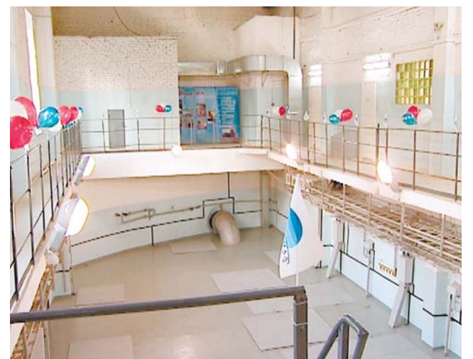
→ Главная насосная станция г. Гатчины
