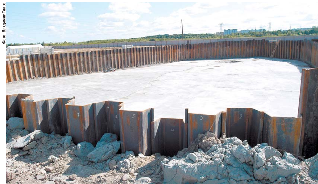
Устойчивость шпунтовой конструкции обеспечивается за счет ее жесткости и благодаря надежной заделке нижних концов шпунтовых элементов в плотные коренные грунты
