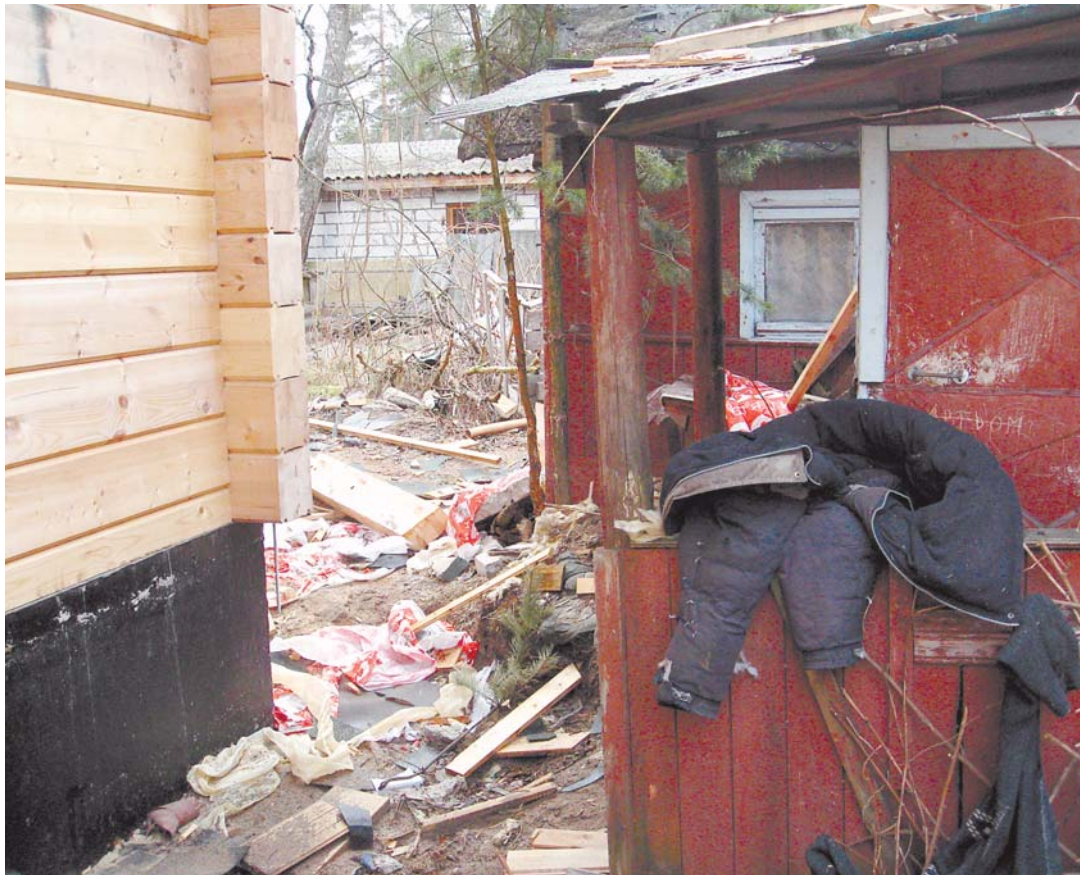
→ Так выглядит «благоустроенный» участок спустя почти год после обозначенного договором срока полного окончания работ
