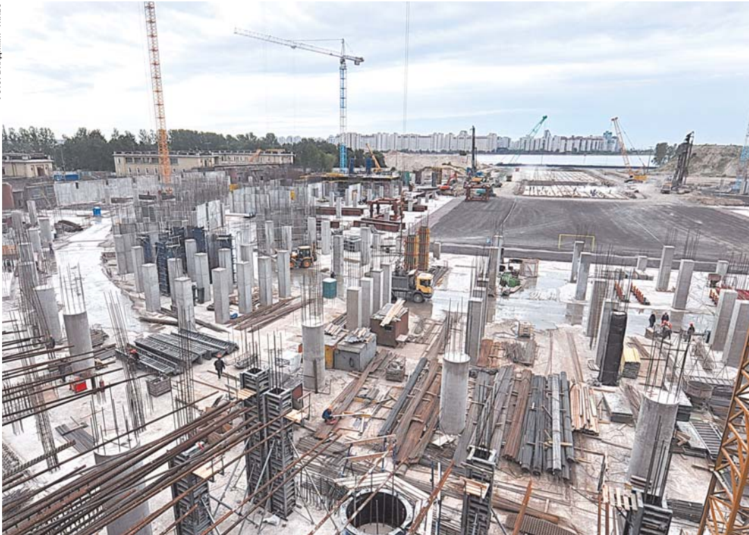
На объекте полностью выполнено свайное поле из 12 тыс. свай. Рядом с площадкой подготовлен причал для приема стройматериалов и крупногабаритных конструкций
