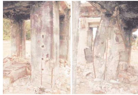
Разрушение железобетонной колонны
