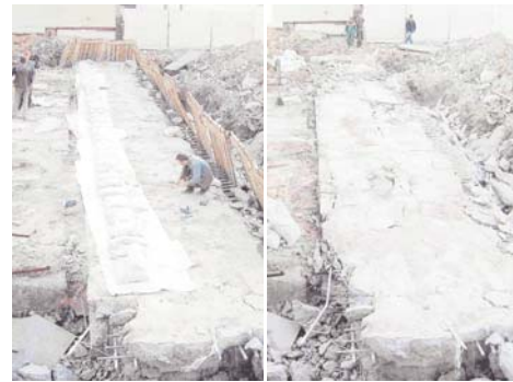
Разрушение фундамента повышенной прочности
