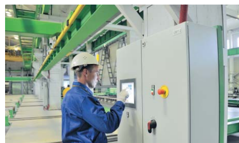
Управление автоматизированной линией осуществляется с нескольких стационарных пультов
