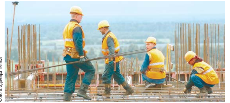
В своей работе строители из ЗАО «ЛенСпецСМУ – Реконструкция» используют самые современные технологии
