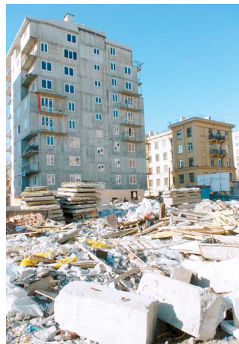
Стройплощадка на Большой Охте на данный момент является одной из самых неблагоустроенных в Петербурге
