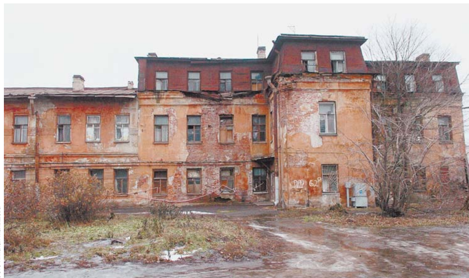
Общежитие на Обводном канале удалось расселить только в текущем году, раньше у города не было возможности для расселения жильцов аварийного здания
