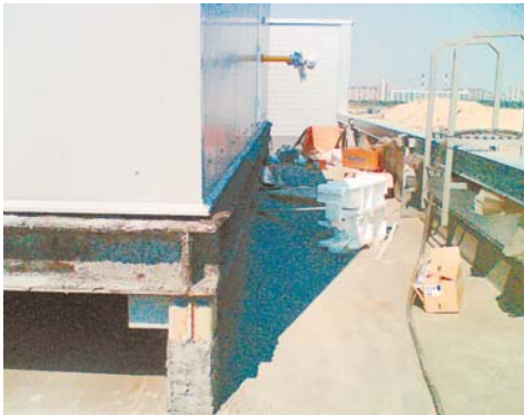
Котельная на кровле
