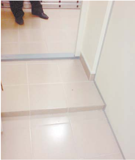
Перепад высот на путях эвакуации
