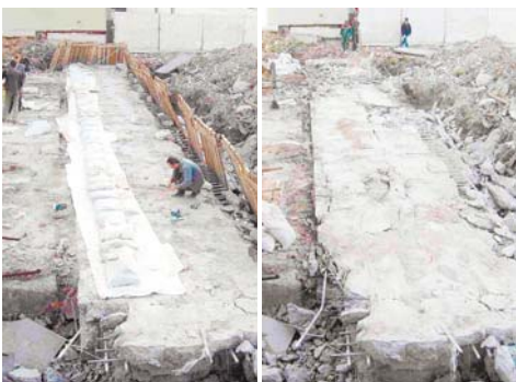
Разрушение фундамента повышенной прочности
