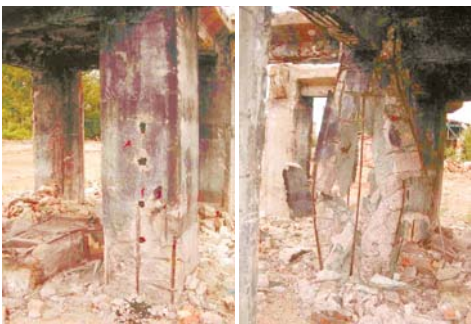
Разрушение железобетонной колонны
